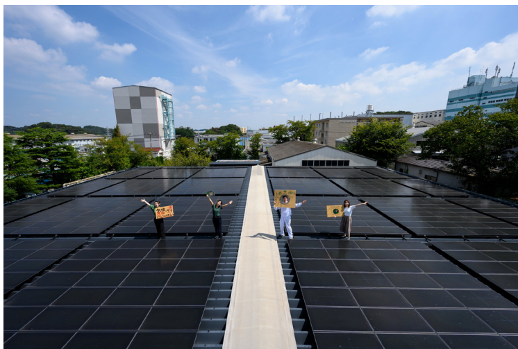
CHES（本社工場）の屋根に設置された太陽光パネル。この電力に加え、青森県横浜町の風力発電を購入することで再エネ100%を実現している
